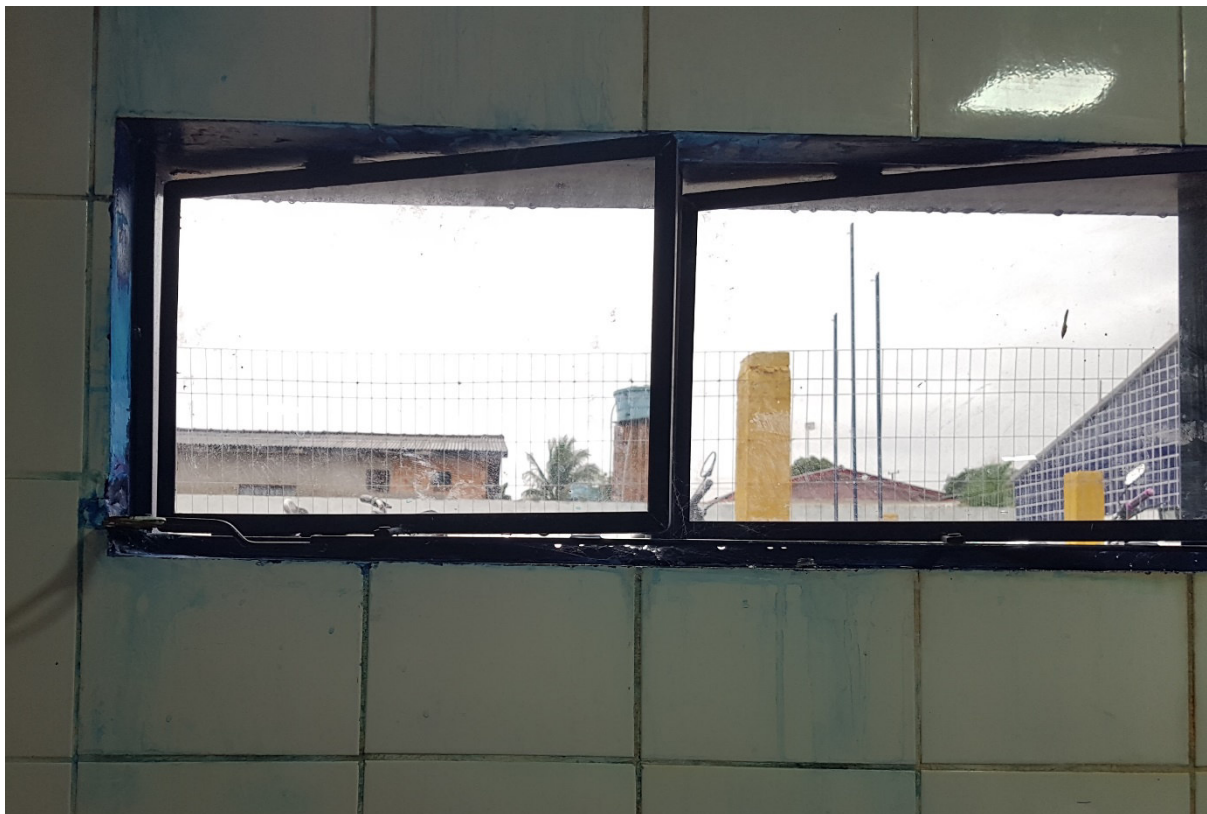
Problemas na pintura ao redor das janelas
