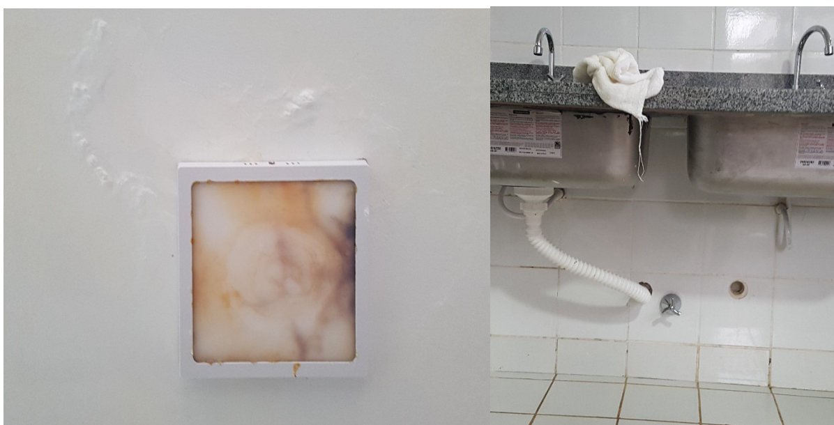
Lâmpada queimada, infiltração e pia sem conclusão da instalação adequada (sifão)
