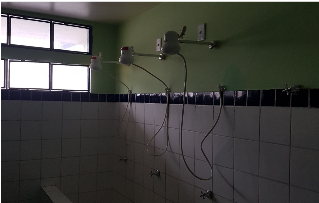
Chuveiros carecendo de ligação elétrica adequada para funcionamento
