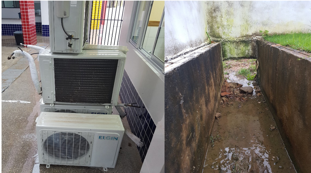
Ares-condicionados para instalação Vala e abertura que carecem de fechamento
